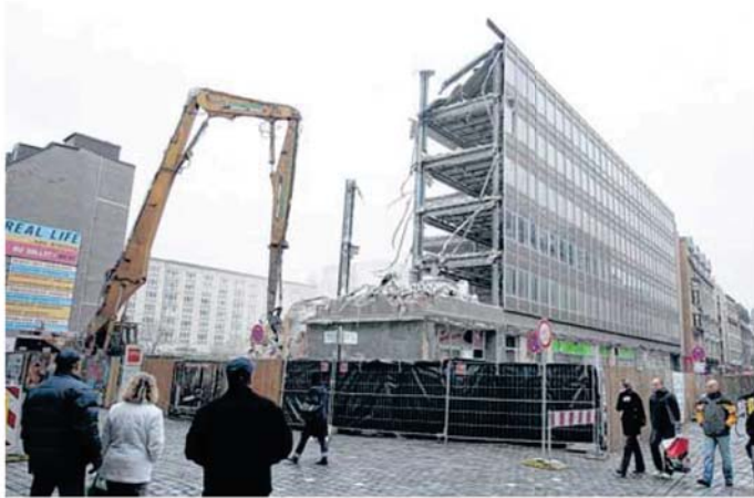
Dem sechsstöckigen Interpelz-Gebäude in der Nikolaistraße schlug vor fünf Jahren schon die letzte Stunde. Heute steht an der Stelle ein Hotelneubau mit 194 Betten. Foto: André Kempner
